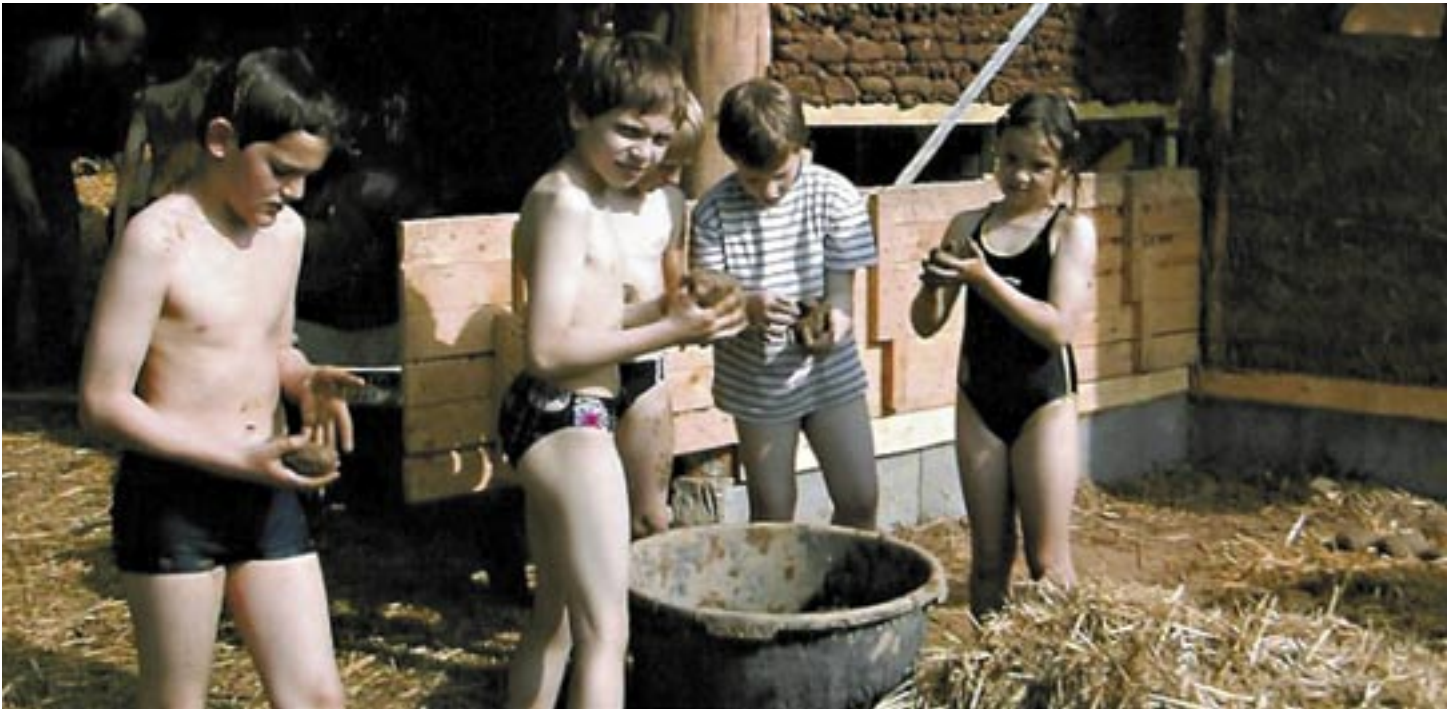
Schülerinnen und Schüler der Friedrich-Junge-Schule in Kiel bauen eine wettergeschützte Hütte aus Lehm auf dem Pausenhof. Gesponsert wurde das Projekt durch das Deutsche Kinderhilfswerk, das Umweltschutzamt sowie die BINGO-Umweltlotterie. Außerdem wurde der Bau mit fachlichem Know-how durch eine Architektin und einen Lehmbauer unterstützt.
